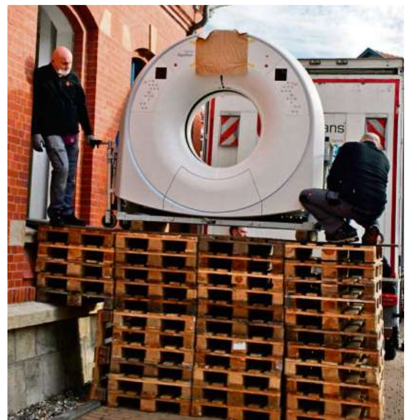
Mithilfe von Paletten wurde der Computertomograph auf Fensterhöhe gehoben und dann ins Zimmer geschoben.
